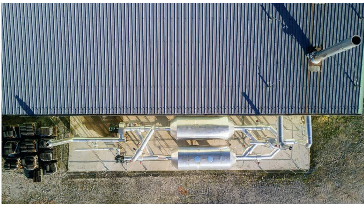
Eco-Stock® in servizio presso il sito di Teguly's per recuperare il calore di scarto da un forno per tegole
