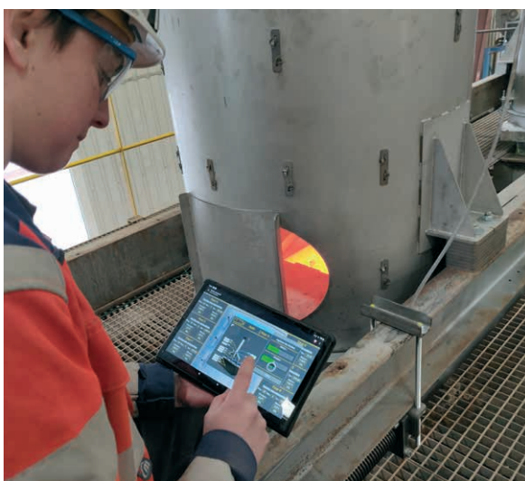
Test durante la messa in funzione di un sistema di raccolta dei fumi ad alta temperatura su uno dei forni per piastrelle e convalida dei sistemi di comando e meccanici, sito di Pontigny.
