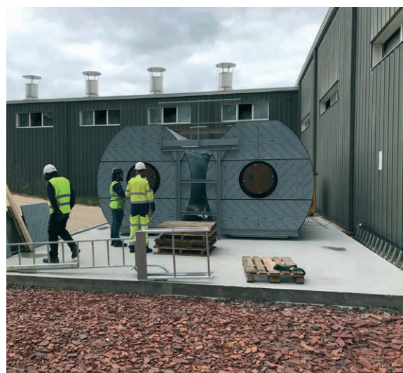
Installazione di due Eco-Stock® presso il sito di Pontigny.
