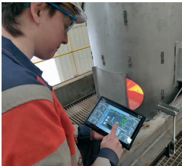
Essais lors de la mise en service d'un système de captage de fumées à haute température sur un des fours de tuilerie et validation du contrôle commande et des systèmes mécaniques, site de Pontigny.
