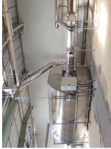
Eco-Stock®, système de stockage thermique haute température développé par Eco-Tech Ceram, dans l'usine de Tegulyls à Mézmac pour valoriser la chaleur fatale issue du four vers le séchoir. Cela permet une économie de 654 MWh/an et évite l'émission de 158 tonnes de CO2/an.
